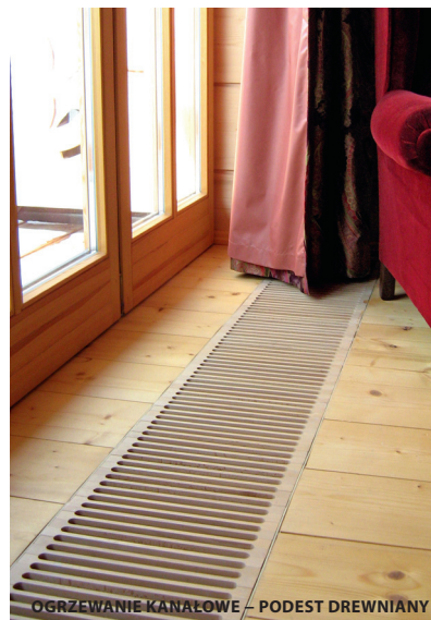
OGRZEWANIE KANAŁOWE – PODEST DREWNIANY
